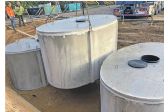
Figuur 3 Installatie van een hemelwaterput. Bron: GEP
