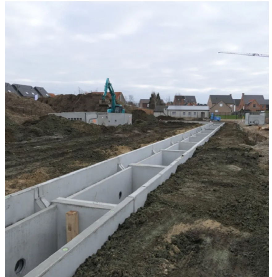
Collector in aanleg in Heist-op-den-Berg. In maart - april 2024 worden de nutswerken ingebouwd.
