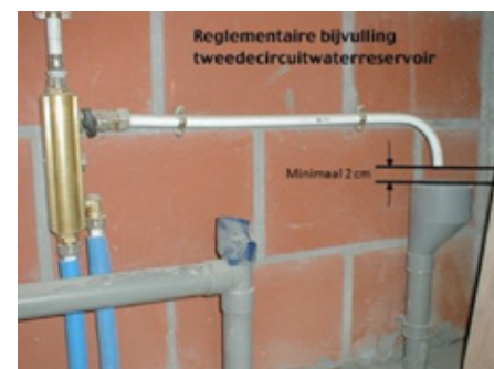
Figuur 5 Fysieke onderbreking tussen twee watercircuits
